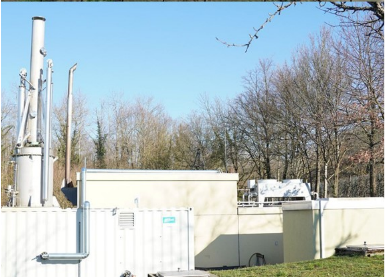
Abbildung 3: Aufstellung des Containers mit Verdichter und Fackel in der Nähe des BHKW's
